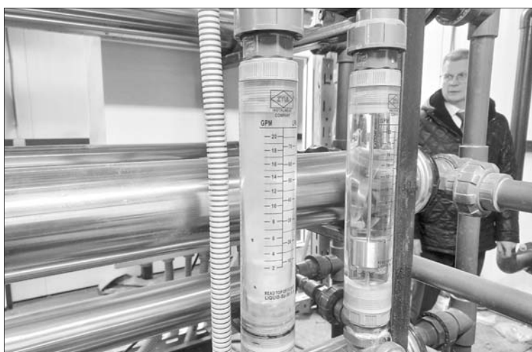
На станции установлены засыпные фильтры, которые убирают всю мутьность и основные примеси, а также система обратного осмоса, очищающая воду
