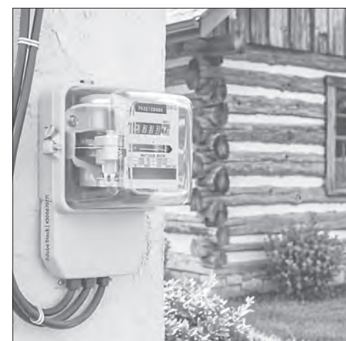
Электросчётчик должен быть всегда в рабочем состоянии
