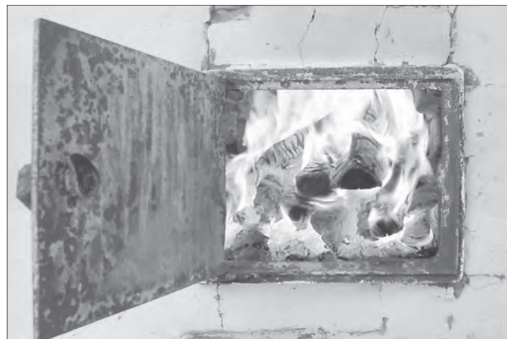
Неисправность печного отопления — одна из самых частых причин пожара
