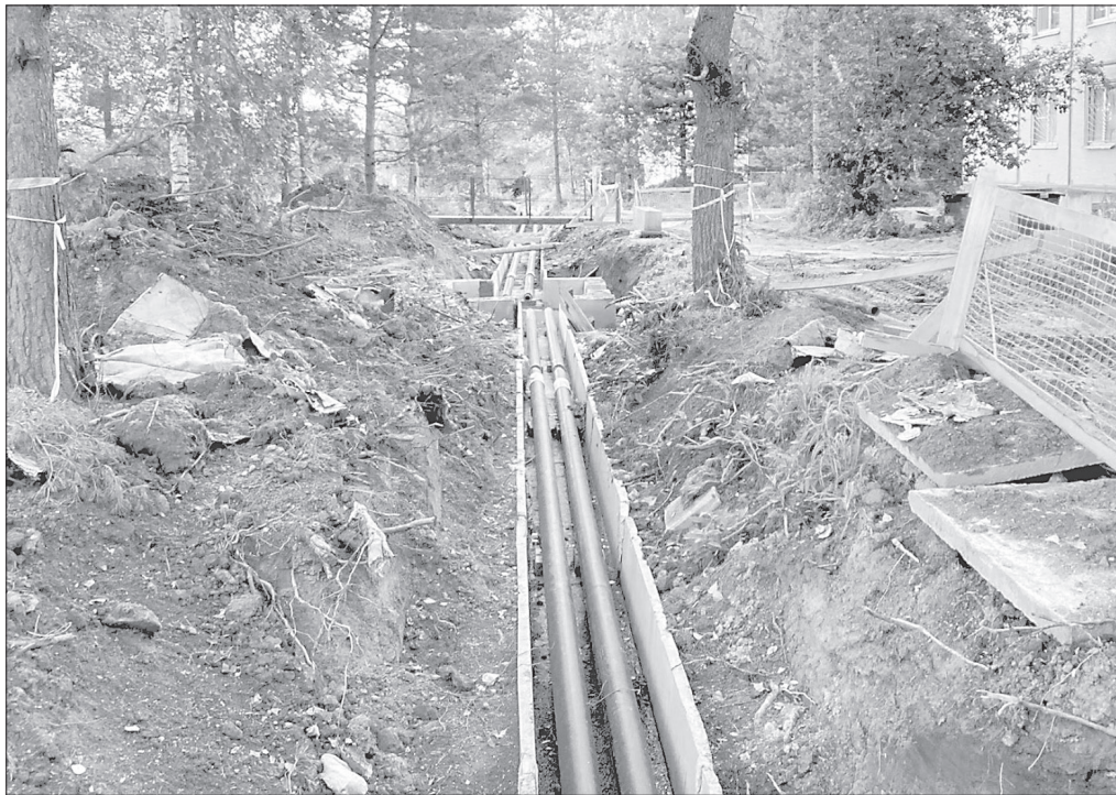
Теплотрассу в Заре не перекладывали с момента основания посёлка
